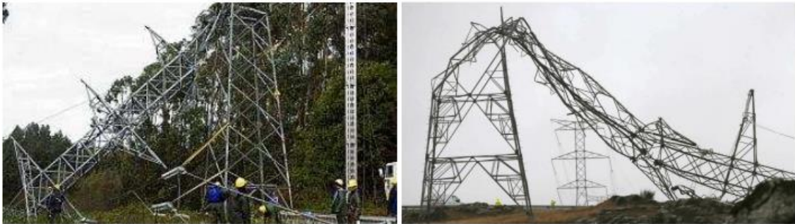
Figura 5.12. Efecto dos temporais en torres de media e alta tensión (esquerda e dereita, respectivamente)
